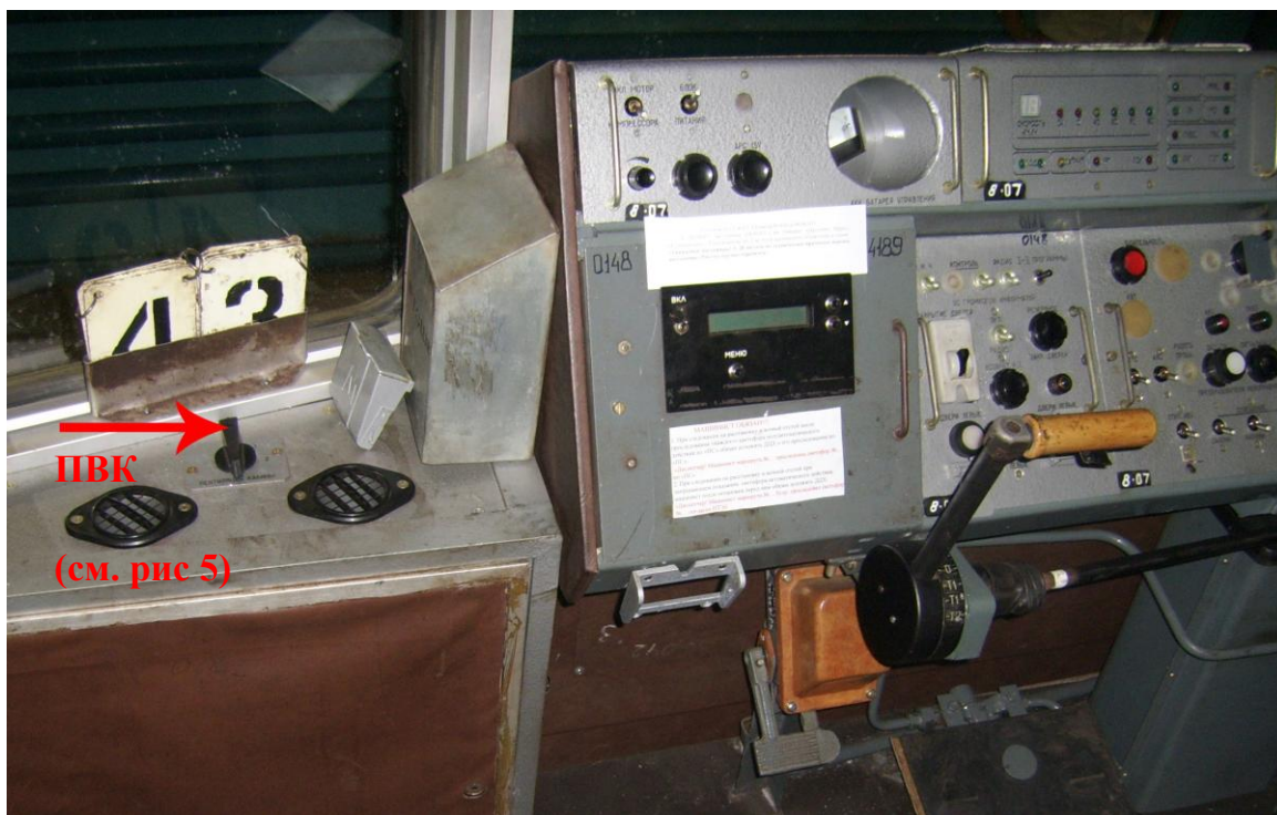
Рис. 5 Панель управления кабины машиниста
